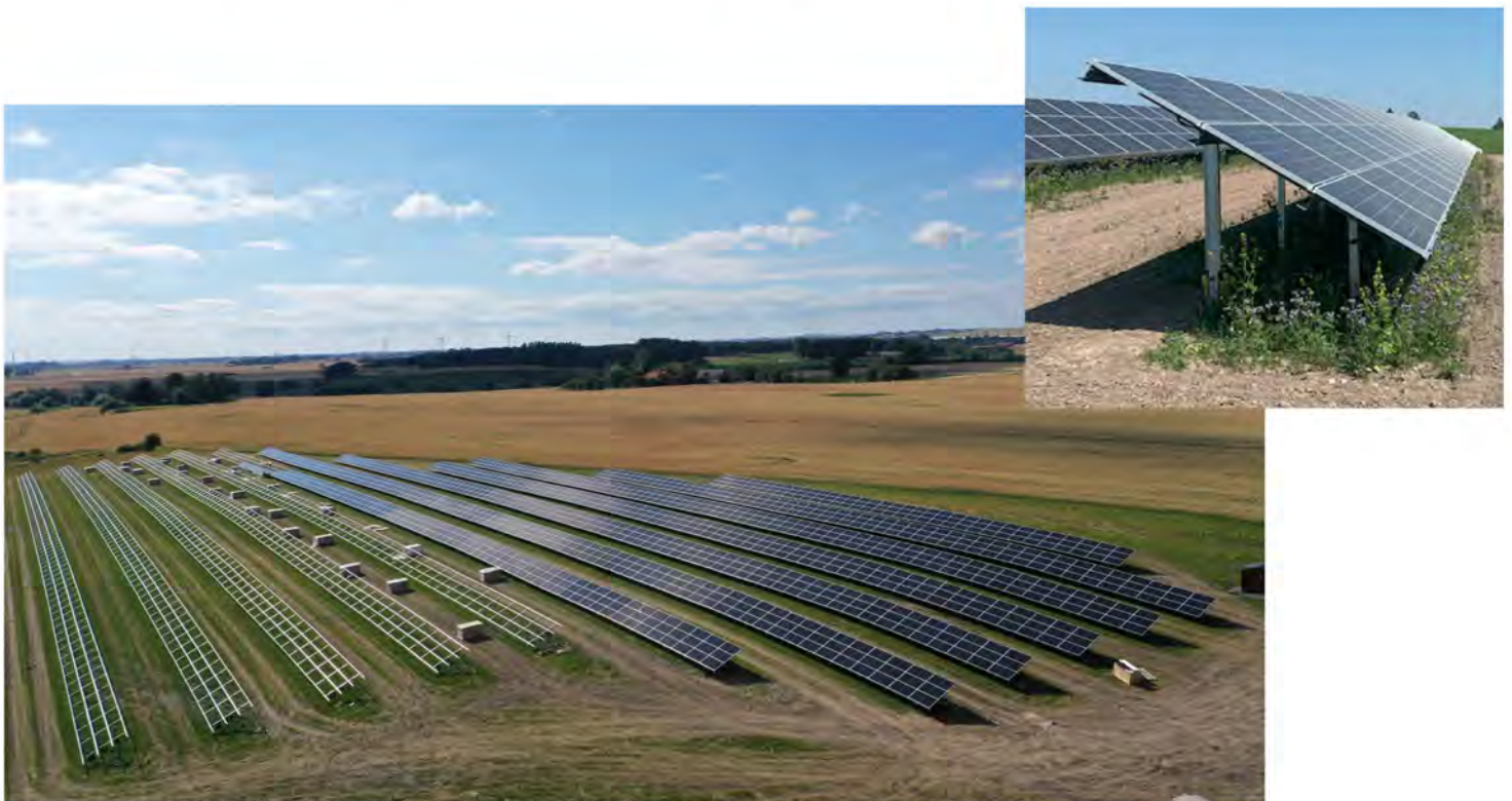
FIGUR 4 Exempel på solpaneler på markställningar. Den vänstra bilden visar pågående montering med markställningar utan solpaneler till vänster och markställningar med solpaneler till höger i bilden (Foto: Magnus Fast, OX2).
