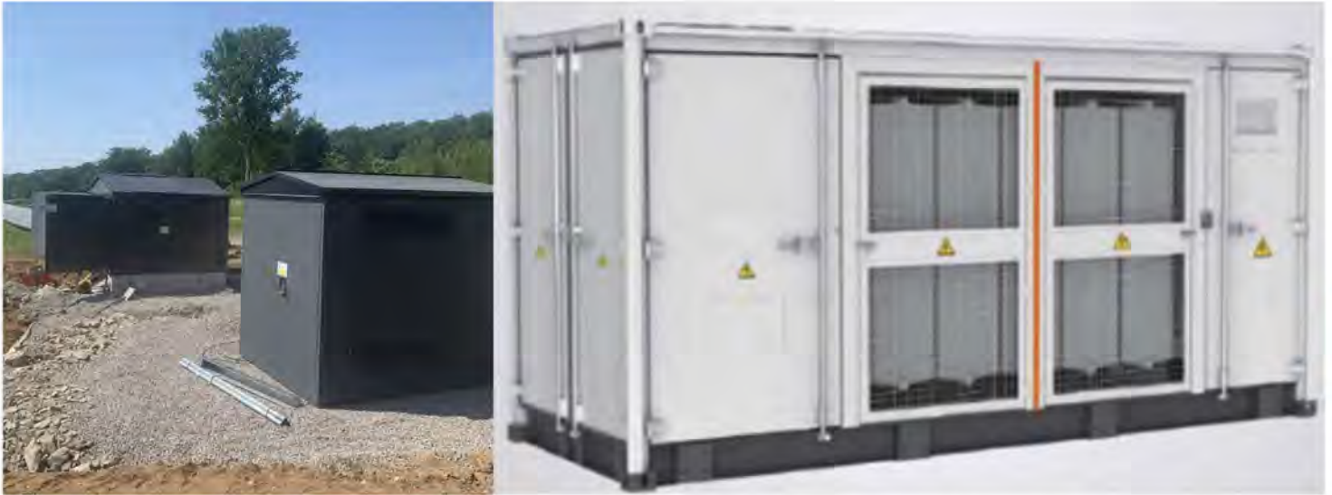
FIGUR 6 Till vänster, exempel på transformatorställverk (Foto: Magnus Fast, OX2). Till höger, exempel på utformning av mottagningsstation (Källa: OX2)
