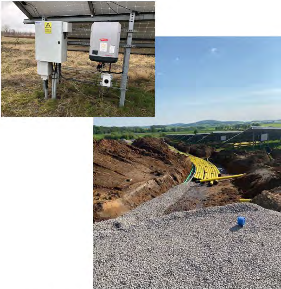
FIGUR 5 Till vänster, exempel på växelriktare som monterats på markställning (Foto: Eco-gain). Till höger, exempel på kabelschakt inom projektområdet (Foto: Magnus Fast, OX2).
