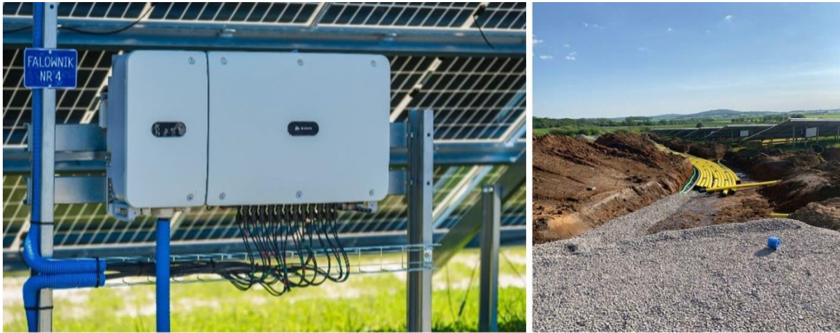
Figur 7. Vänster: växelriktare som monterats på markställning (bildkälla: www.ske-solar.com). Höger: exempel på kabelschakt inom solparken (foto: Magnus Fast, OX2).
