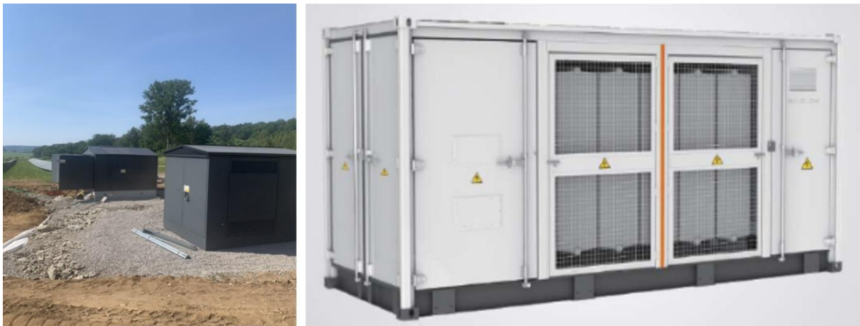
Figur 8. Vänster: exempel på utformning av transformatoriosk (foto: Magnus Fast OX2).
