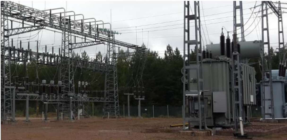
Figur 9. Exempel på ställverk för anslutning av solparken till elnätet (Bildkälla: www.vattenfall.com ).
